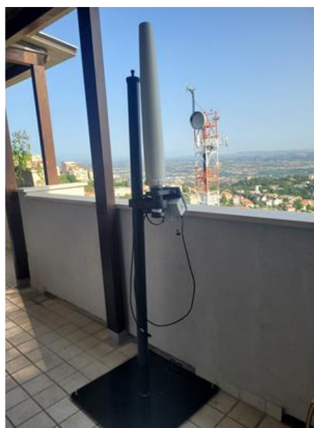
Fig.2 centralina monitoraggio in continua
